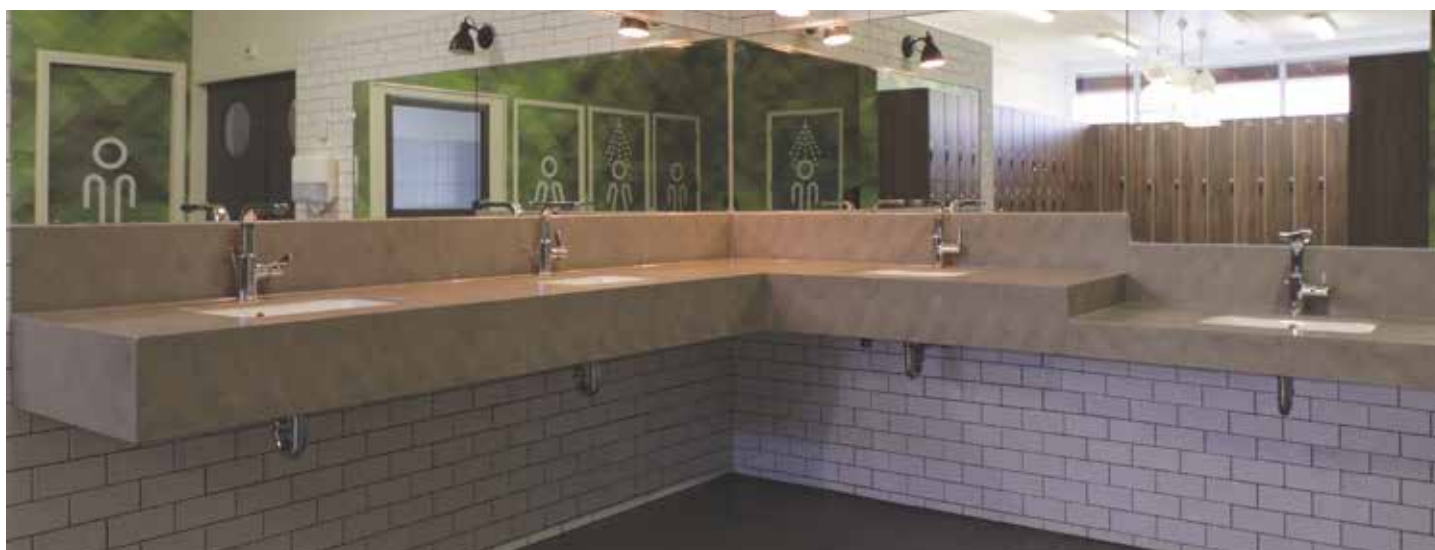
Hermeta sanitaire ruimte met verlaagde en onderrijdbare wastafel
